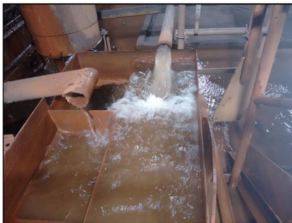
Figura 36 - Escoamento de água irregular pelas descargas de água de selo da bomba
