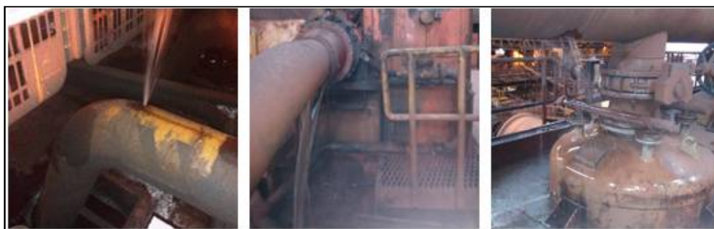
Figura 3 - Vazamentos em tubulação de vácuo, filtro de disco e vaso separador de filtrado
