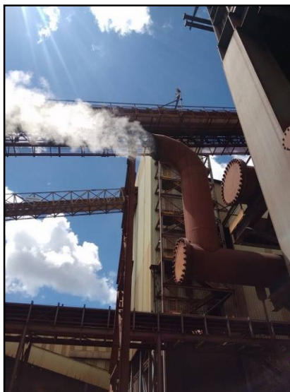
Figura 18 - Descarga de ar aspirado das bombas de vácuo
