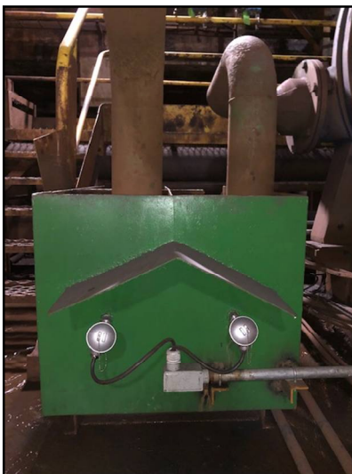
Figura 44 - Medidores de temperatura instalados nas descargas da bomba de vácuo
