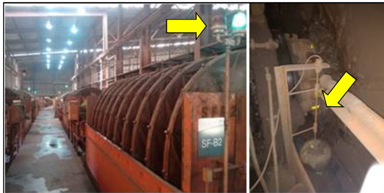
Figura 50 - Sinais instalados (esquerda) e boia com sensor indutivo (direita)
