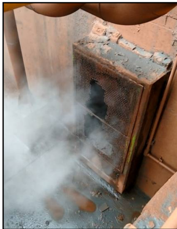
Figura 37 - Descarga de ar aspirado pelas bombas de vácuo em Mina Fábrica
