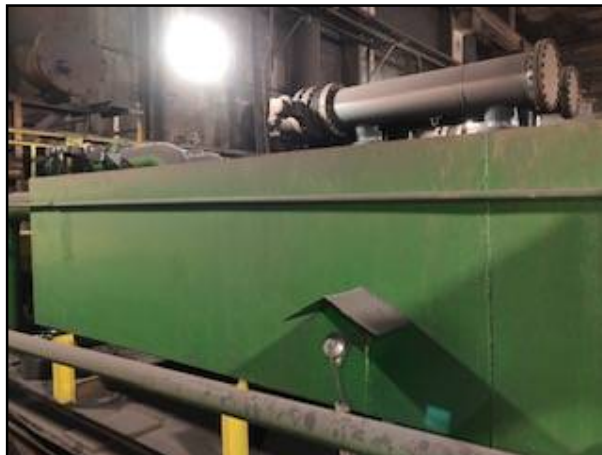
Figura 43 – Medidor de temperatura instalado no reservatório de alimentação de água das bombas de vácuo
