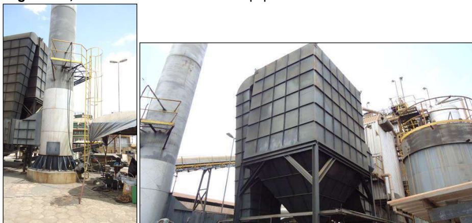
(a) Chaminé H=30 metros. (b) multiciclone H=10 metros.
