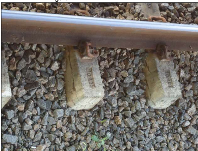
Figura 7 – Dormentes de concreto.
